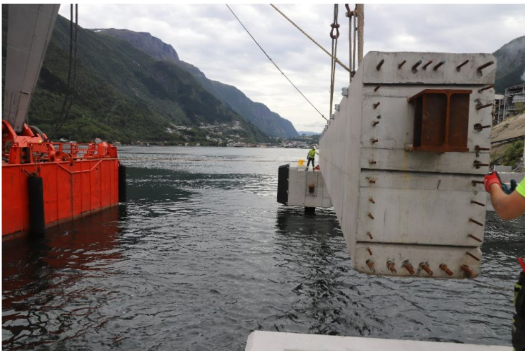
SYRE: Boliden Odda bygger i desse dagar ny syrekai aust på Eitrheimsneset. Foto: Boliden Odda
